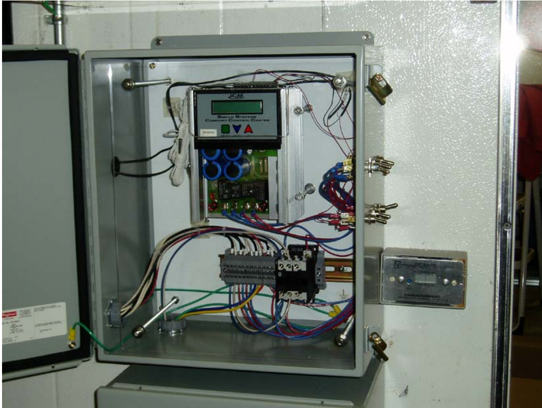
Fig. 3.4. Fan motor speed controls
