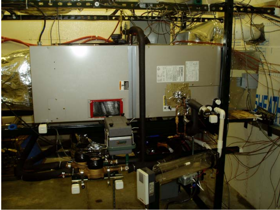
Fig. 3.5. Indoor fan coil.
